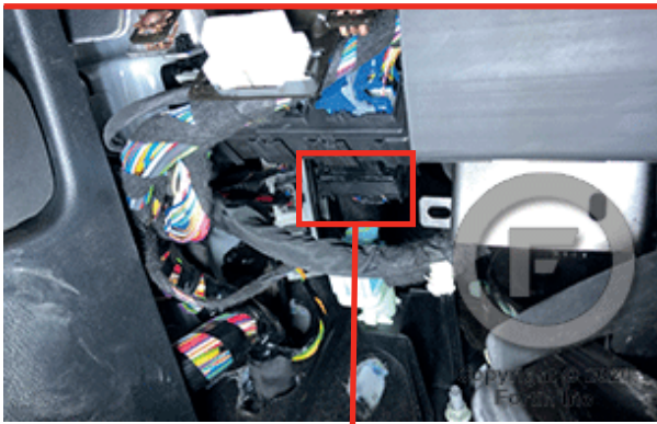
① Gateway module, located at dash board driver's side, Module Passerelle réseau, situé au tableau de bord côté conducteur.
