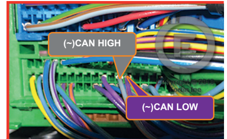
④ At the fuse box À la boîte à fusibles
