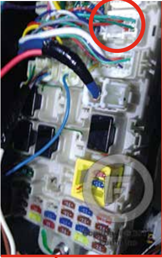
④③ Fuse box Boîte à fusibles
