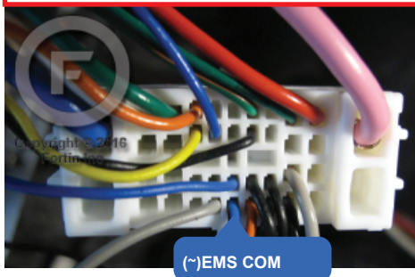
① Fuse box Boite à fusibles
